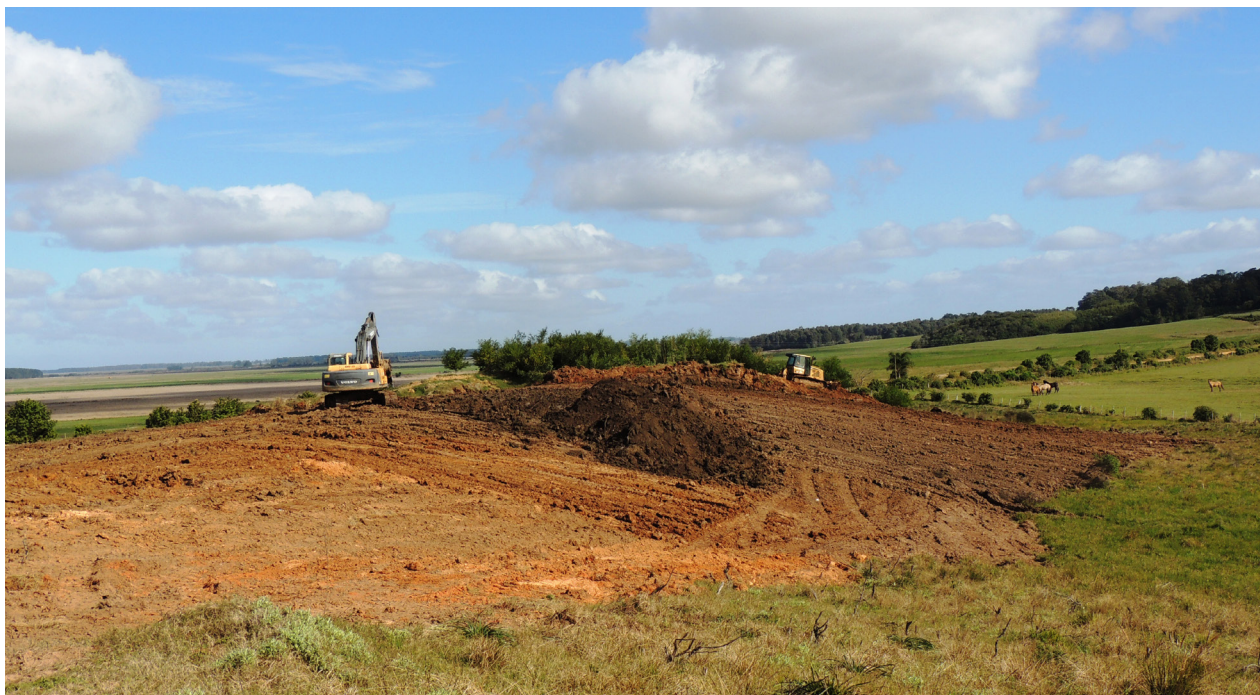
Jazida de extração de argila no Lote 9, em Pelotas, está em processo de recuperação para que as condições ambientais sejam restabelecidas
